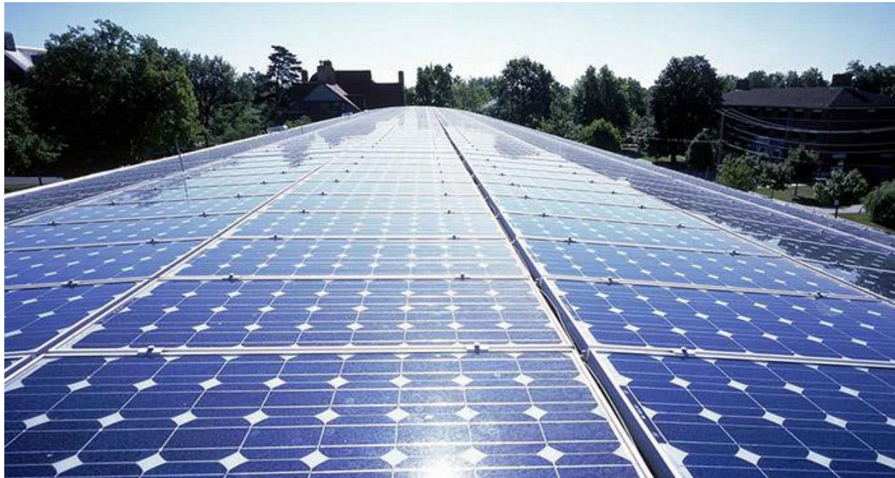
یک آرایه‌ی بزرگ سیلیکونی که روی بام یک ساختمان تجاری نصب شده است.
